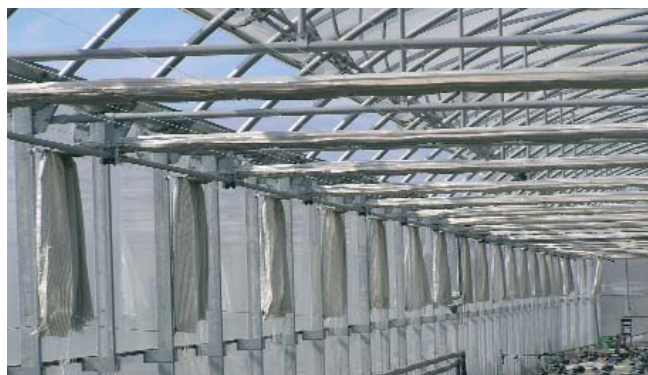
Sistema de sombreado
